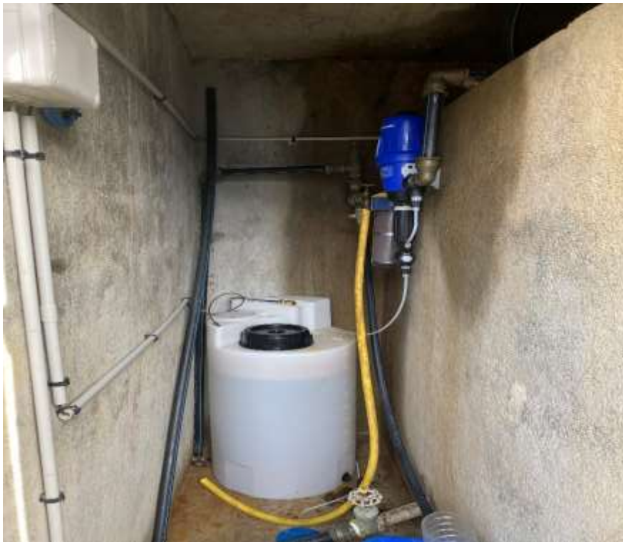
Système de dosage du chlore sur le réservoir de Balacet
